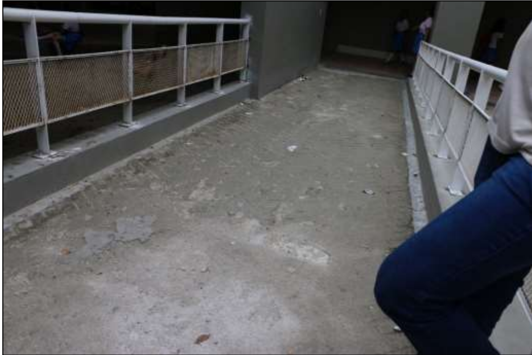
Fotografía No. 4 Vista general del tramo final de la rampa de acceso al segundo nivel, Instituto Magdalena. El acabado de piso de esta obra, se encuentra parcialmente perdido y desprendido, por efecto del lavado por el escurrimiento del agua superficial. Lo anterior, se ocasionó por debilidad en el proceso constructivo y en el material instalado.
