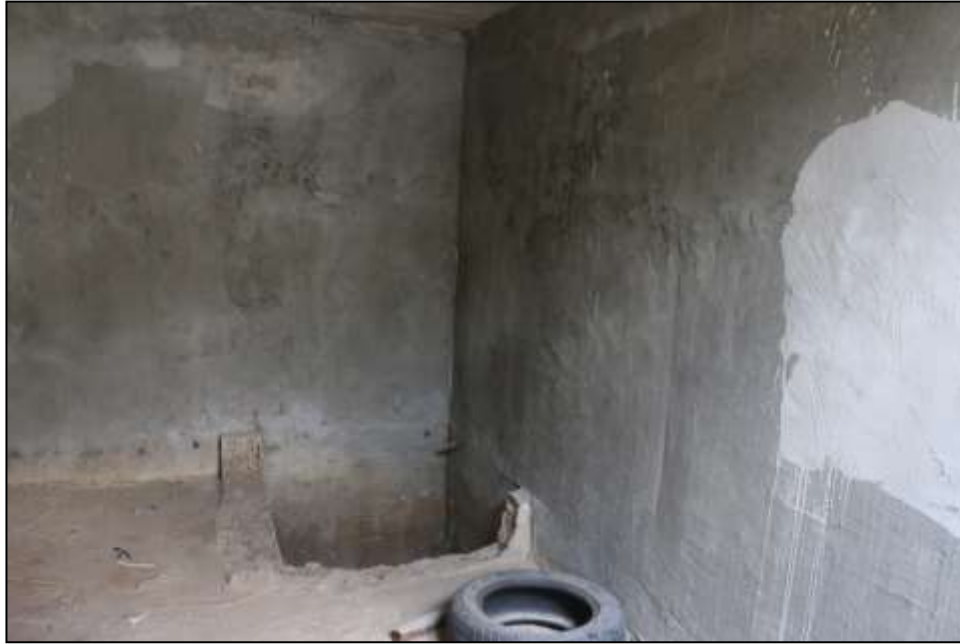
Fotografía No. 2 Vista general del pozo de eyección, dentro del cuarto de bombeo, IED Rodrigo de Bastidas. En la imagen quedó registrado el espacio en donde fue ubicado el pozo de inspección. No obstante, no se instaló ningún equipo de bombeo, que garantice su utilidad frente al riesgo de inundación de este cuarto.
