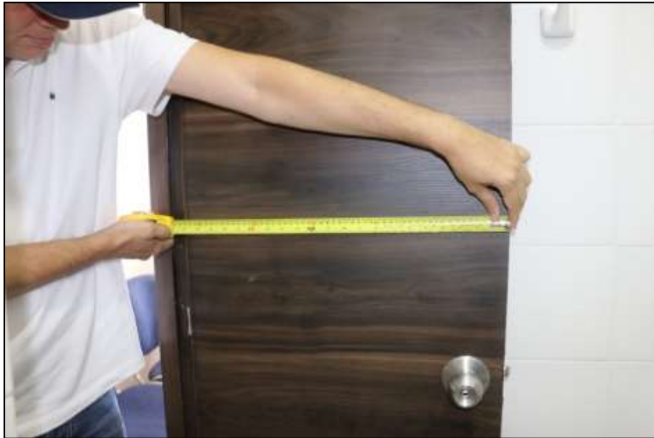
Fotografía No. 7 Detalle de una de las puertas de madera, instaladas en uno de los baños de la zona de oficinas del bloque A, Instituto Magdalena. El ancho de las puertas instaladas no cumple con la especificación técnica del contrato de obra.
