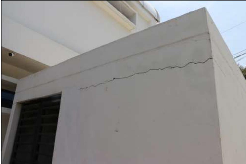
Fotografía No. 1 Detalle de la parte superior de uno de los muros del cuarto de máquinas, construido para uso del Centro de Salud La Paz. En la imagen, quedó registrada la grieta longitudinal que presenta este elemento.
