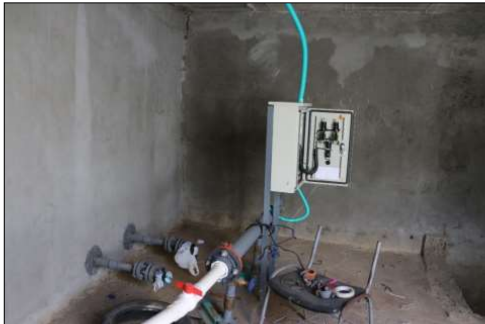
Fotografía No. 3 Vista general del cuarto de bombeo de suministro, IED Rodrigo de Bastidas. En la imagen se presentan la instalación del sistema de bombeo, en donde se evidencia la ausencia de las 2 bombas y del hidroneumático.
